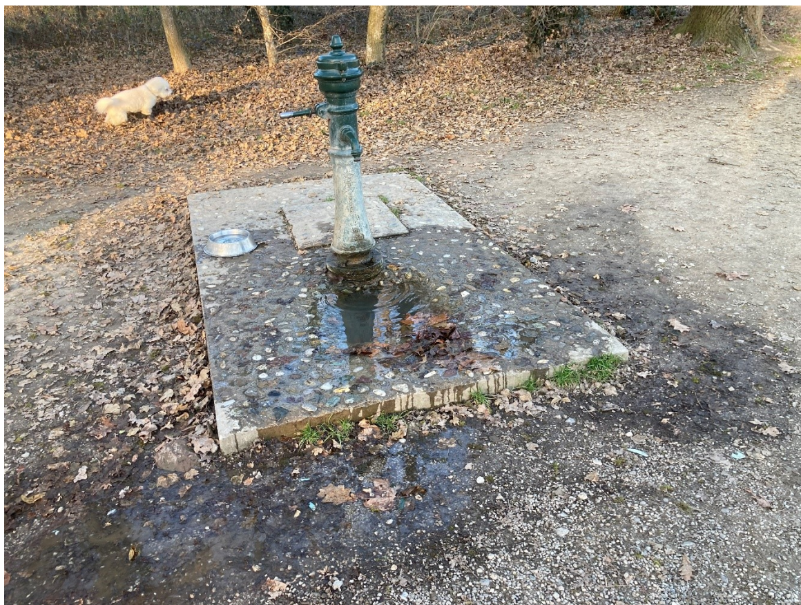
Slika 6.5 Otežani pristup pumpi za vodu
