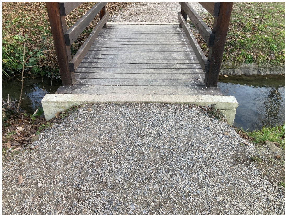
Slika 6.6 Otežani pristup na mostu
