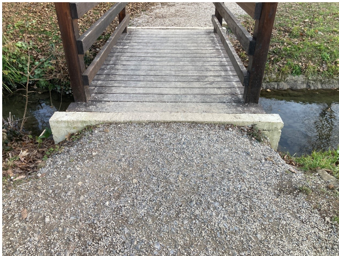
Slika 6.6 Otežani pristup na mostu
