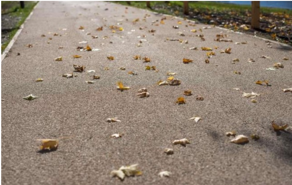
Slika 7.3. Primjer obloge od Stabilizer 2000.
